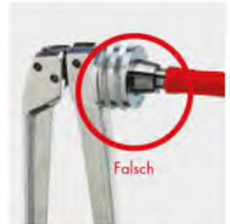
Rohr nicht vollständig auf Aufweitkopf aufgesteckt
